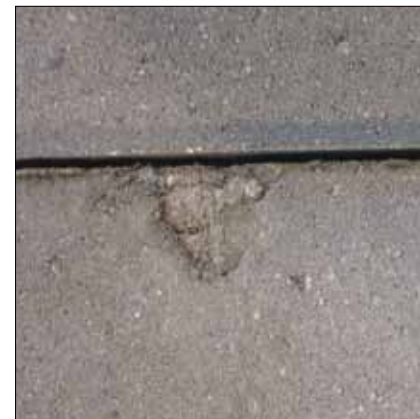
Øverst ses revner i overfladen som følge af fejl i støbningen eller håndteringen. Nedenunder et eksempel på mangelfuld fyldning af formen, der har givet en fordybning i kanten af flisen, skal sorteres fra før lægningen.
